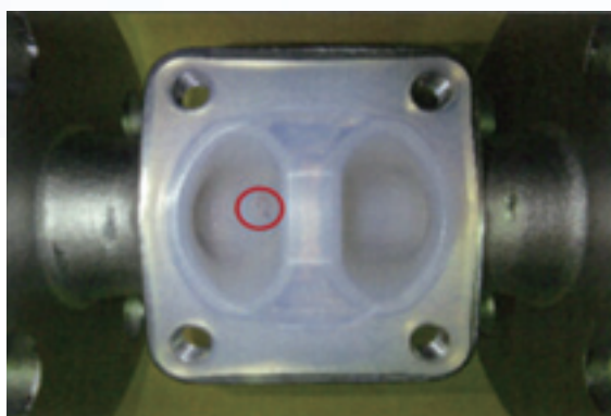
赤丸印部にピンホール発生
